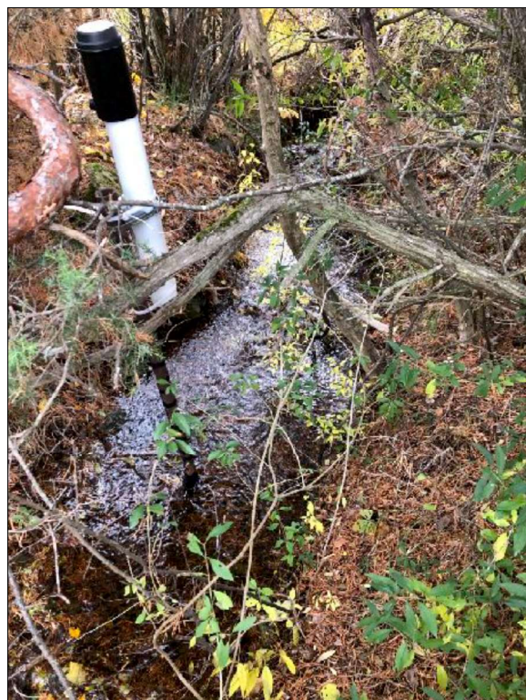
Figur 11. Det mätrör som står vid utflödet av diket i norr till slukhållet. Foto Dan Carlsson
